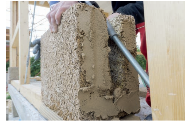
木製フレームにCANAPLOCK(カナブロック)を敷き詰める様子。このブロックは一般的なのこぎりで容易に切断できます。耐震構造を実現するために加工することができます。
